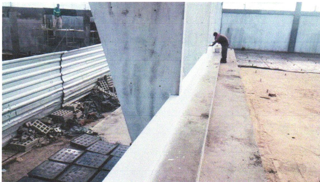
IMAGEM 08 - APLICAÇÃO MANUAL DE MASSA ACRÍLICA EM PAREDES EXTERNAS DE CASAS, DUAS DEMÃOS. AF_05/2017
